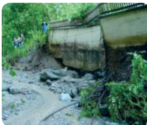
Bereich Hechenblaikner Markus war ein sehr kritischer Punkt. Die Gartenmauer wurde vom Bach komplett unterspült und sogar Teile vom Rasen sind abgebrochen. Bei länger anhaltendem Unwetter hätte das Haus evakuiert werden müssen. Foto 17.7. 7.00 Uhr Begehung Bürgermeister Hubert Hußl mit den Verantwortlichen der Wildbachverbauung.
