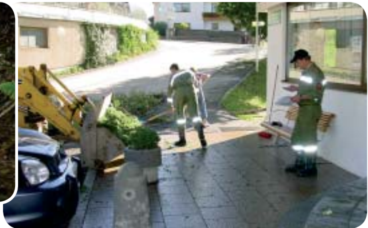
Aufräumarbeiten vor dem Gemeindehaus, die Blumen nordseitig sind total verwüestet worden.
